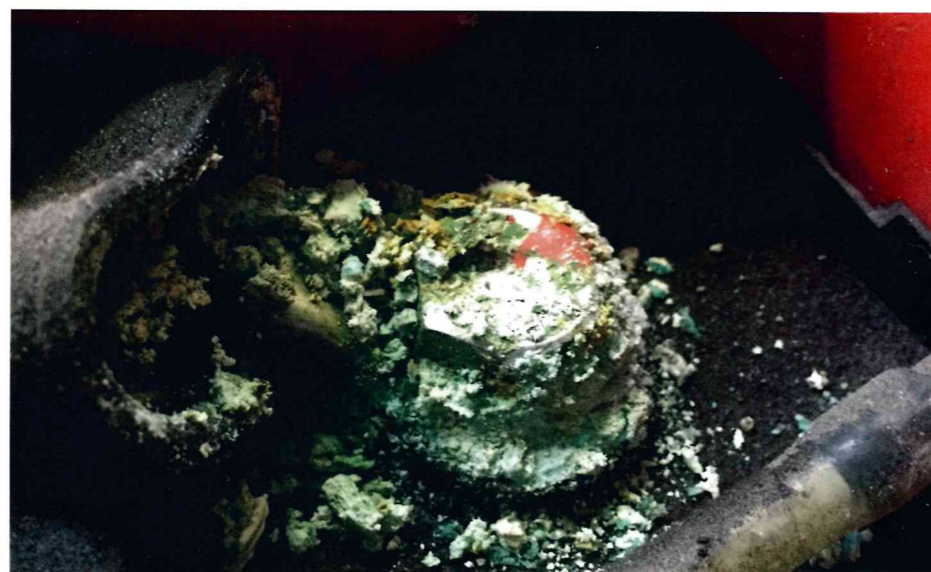
ABB. 1: EIN LEIDER HÄUFIG GESEHENES BILD: IN DIESEM STADIUM DER KORROSION IST DIE BATTERIEZELLE KAUM NOCH ZU RETTEN.
